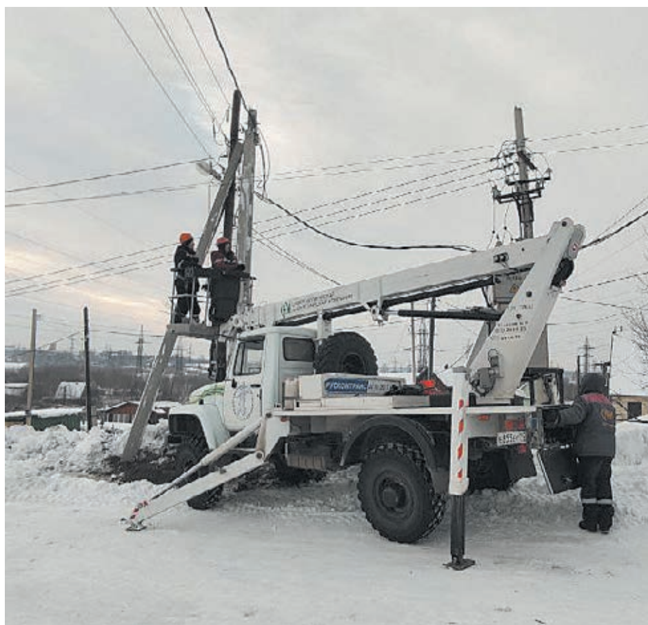
■ В Кемерове энергетики АО «Кемеровская горэлектросеть» больше чем на 90% обновили низковольтные воздушные линии электропередачи с применением современных материалов.
