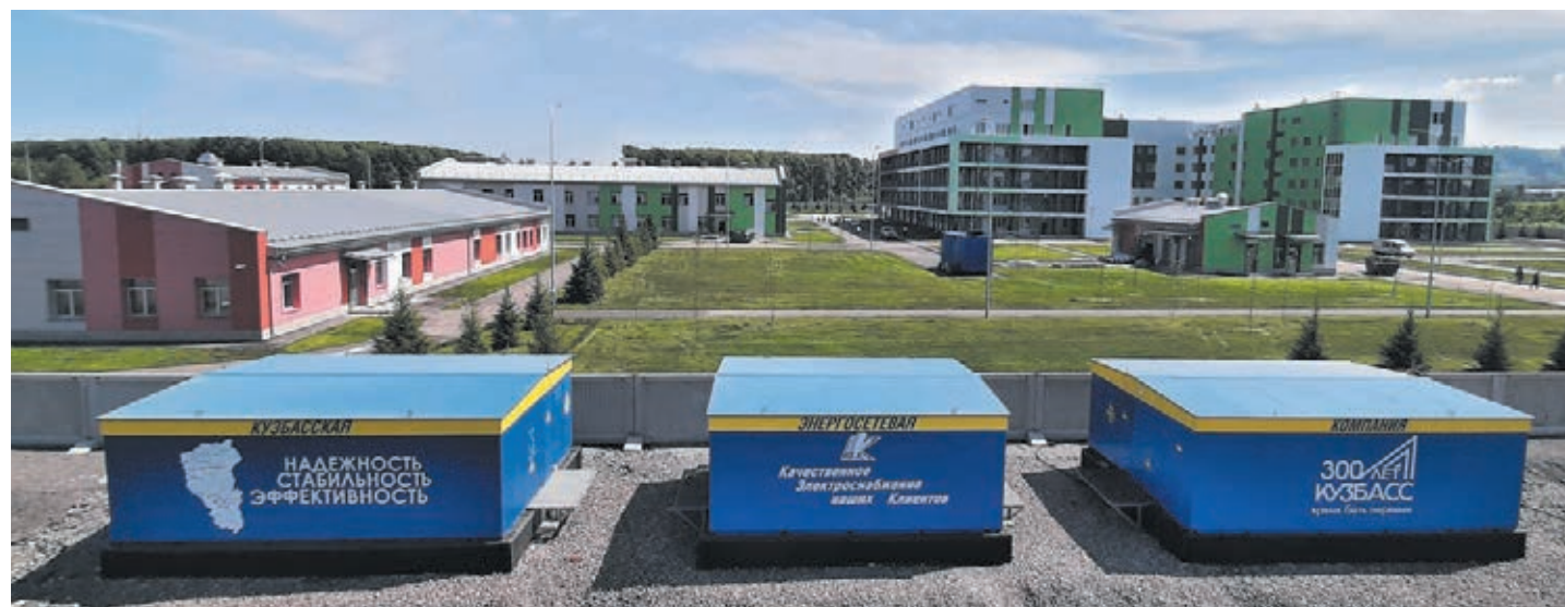
■ Три трансформаторные подстанции номинальной мощностью 5,26 МВА для электроснабжения инфекционной больницы в г. Новокузнецке.
