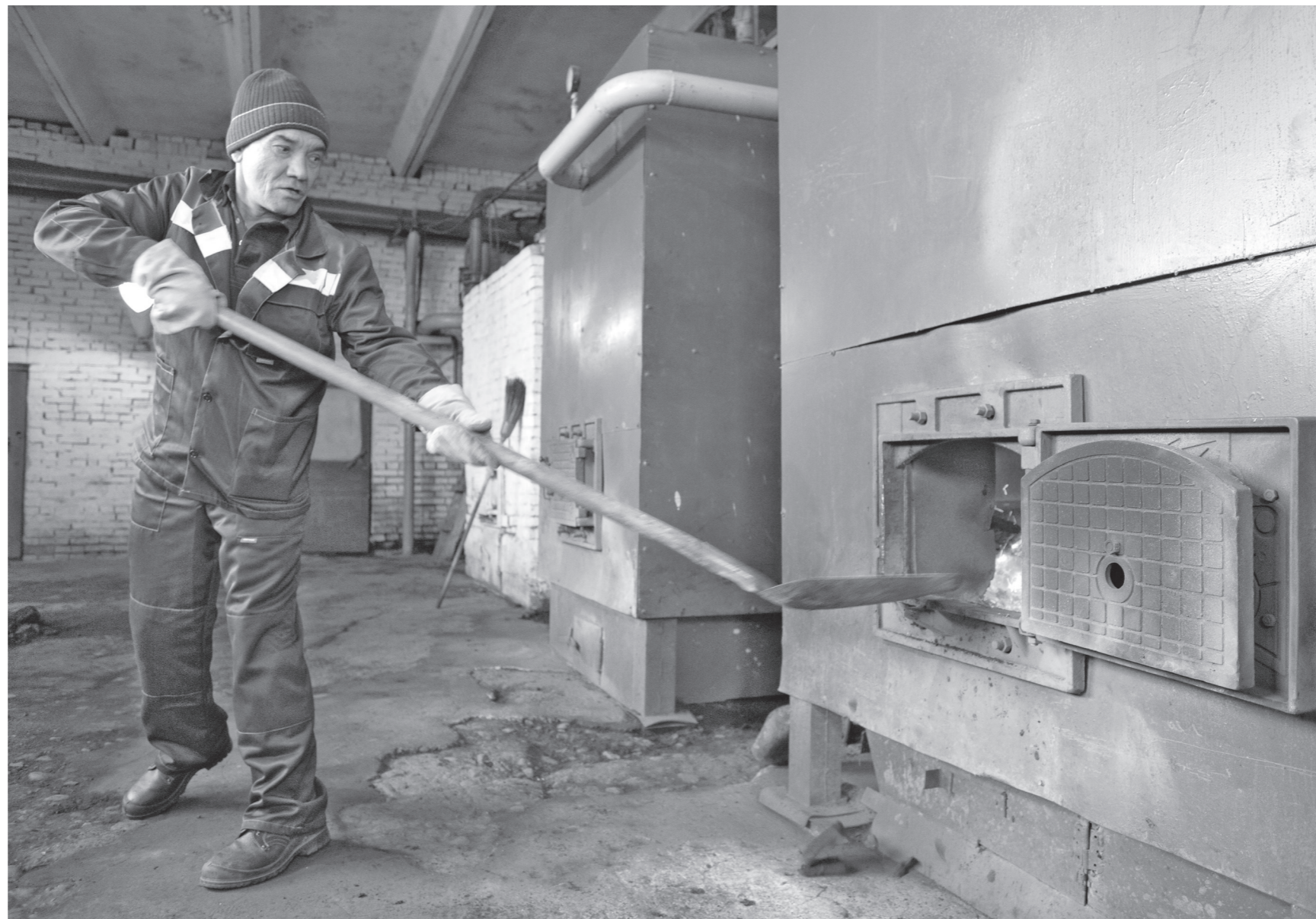
Котельная №9 поселка Тисуль работает на буром угле всю зиму, бесперебойно снабжая тепло объекты социальной сферы. Фото Сергея Гавриленко.
