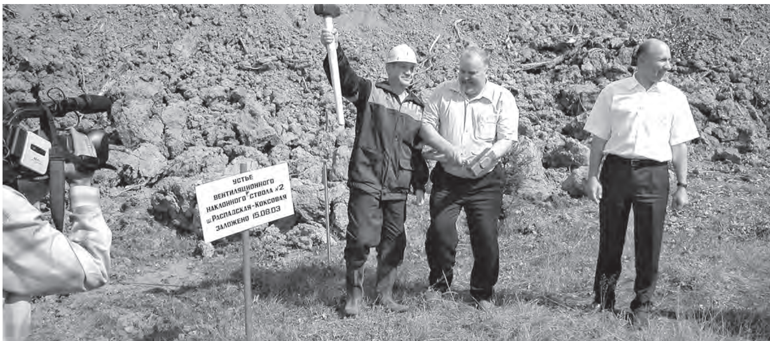
■ В это время активно возводятся новые предприятия. На снимке: первый колышек на месте строительства шахты «Распадская-Коксовая», 15 августа 2003 года. Фото из фондов Госархива Кемеровской области.
