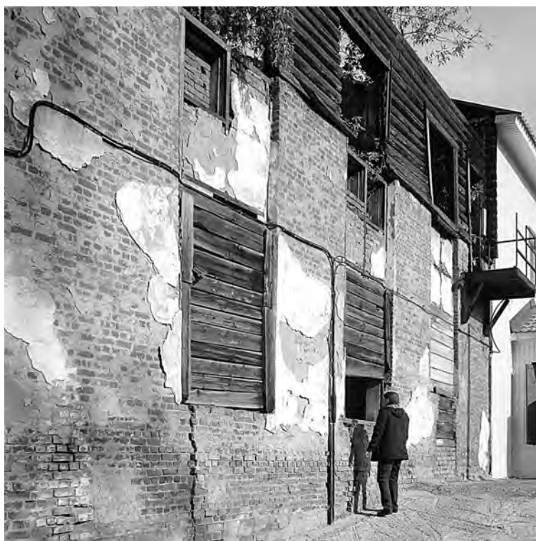
Здание школы на Руднике сейчас в разрушенном состоянии. Фото из архива Татьяны Кардаильской.
