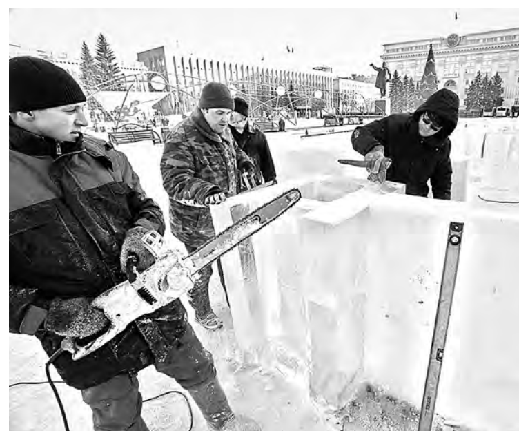
■ КРУГОМ СКАЗКИ. В Кемерове вовсю ведется строительство ледяного городка по мотивам сказок А.С. Пушкина. Литературная тема - лейтмотив наступающего 2015 года. Фото Федора Баранова.
