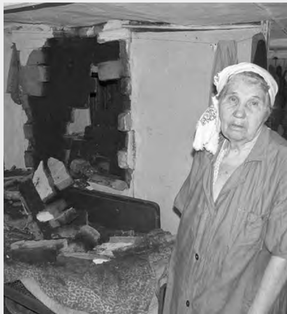
В поселке Бачатский на улице Калинина разрушило печь.
