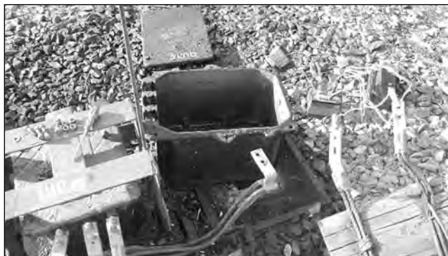
Выведенные из строя дроссель-трансформаторы создают реальную угрозу безопасности движения поездов и людей на железной дороге.
