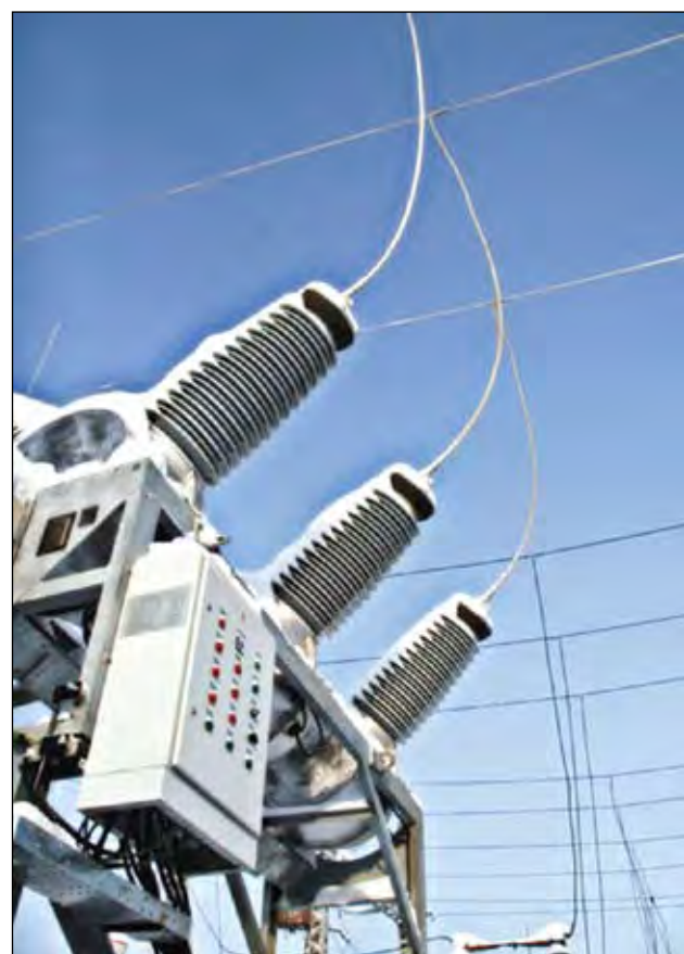
Новый выключатель на подстанции «Кондомская».
