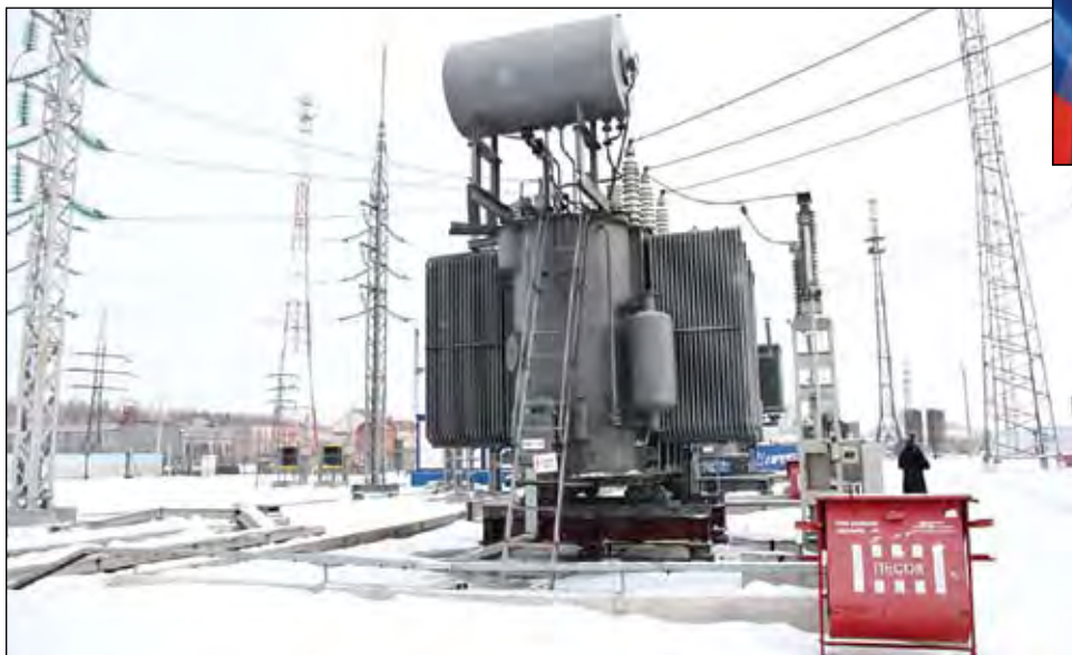
Оборудование подстанции отвечает самым современным требованиям.
