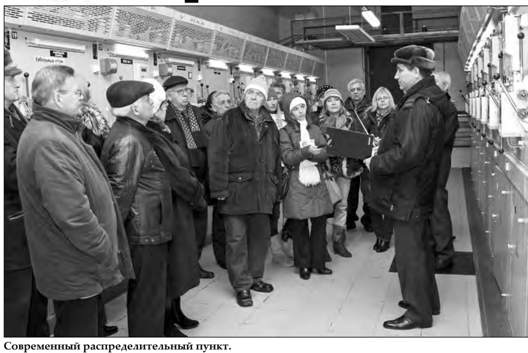
Современный распределительный пункт.
